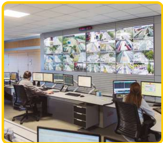
PCC – Puesto de Control Central
