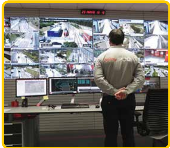
PCC – Puesto de Control Central
